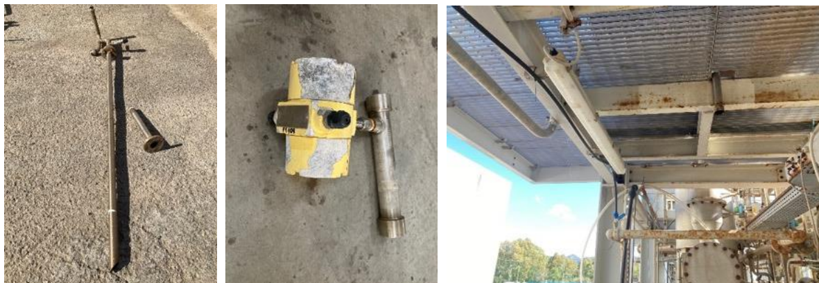
Figura 2.23. Componenti e area dopo lo smontaggio.
