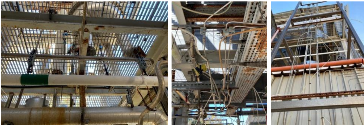
Figura 2.50. tubazioni rilsan e acciaio da rimuovere ai livelli 0, 3100 e rastrelliera.
