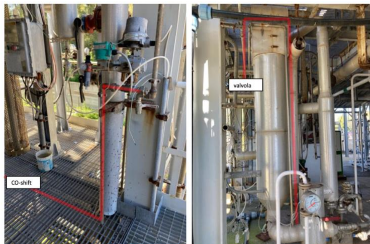
Figura 2.34. Tubazione di intercettazione syngas a valle del RO001 a FU120.
