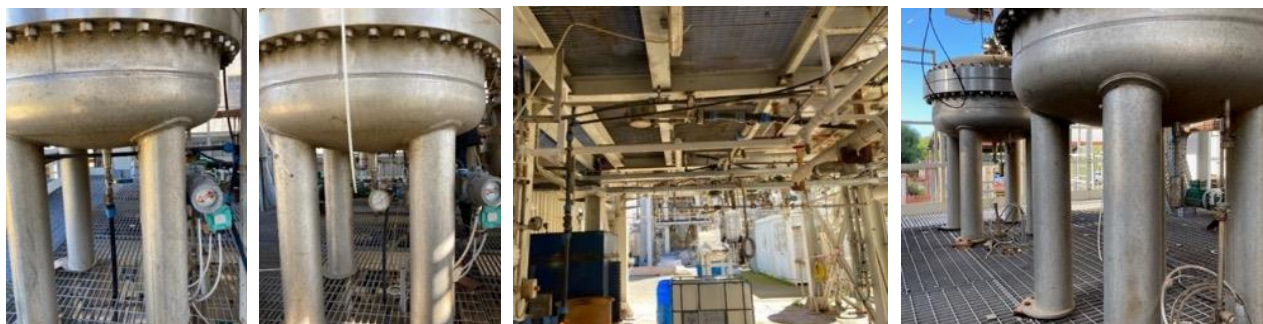
Figura 2.41. Reattori di cattura della CO 2 e tubazioni di carico e scarico in PE e reattori dopo la rimozione della tubazione.
