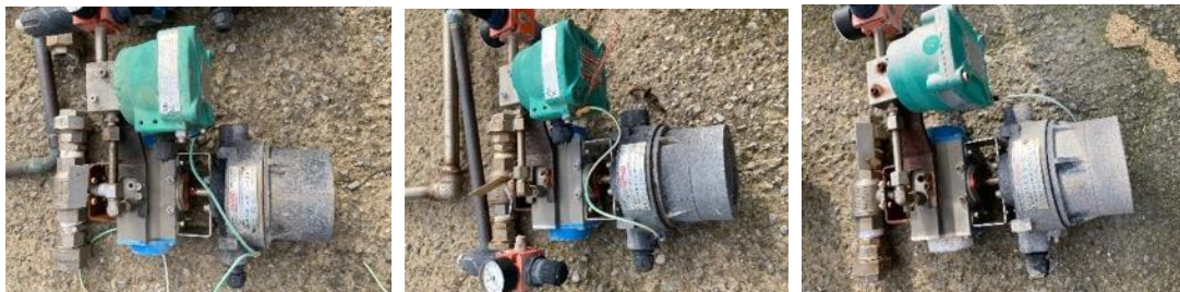
Figura 2.47. valvole FU133, FU134, FU136 dopo lo smontaggio.
