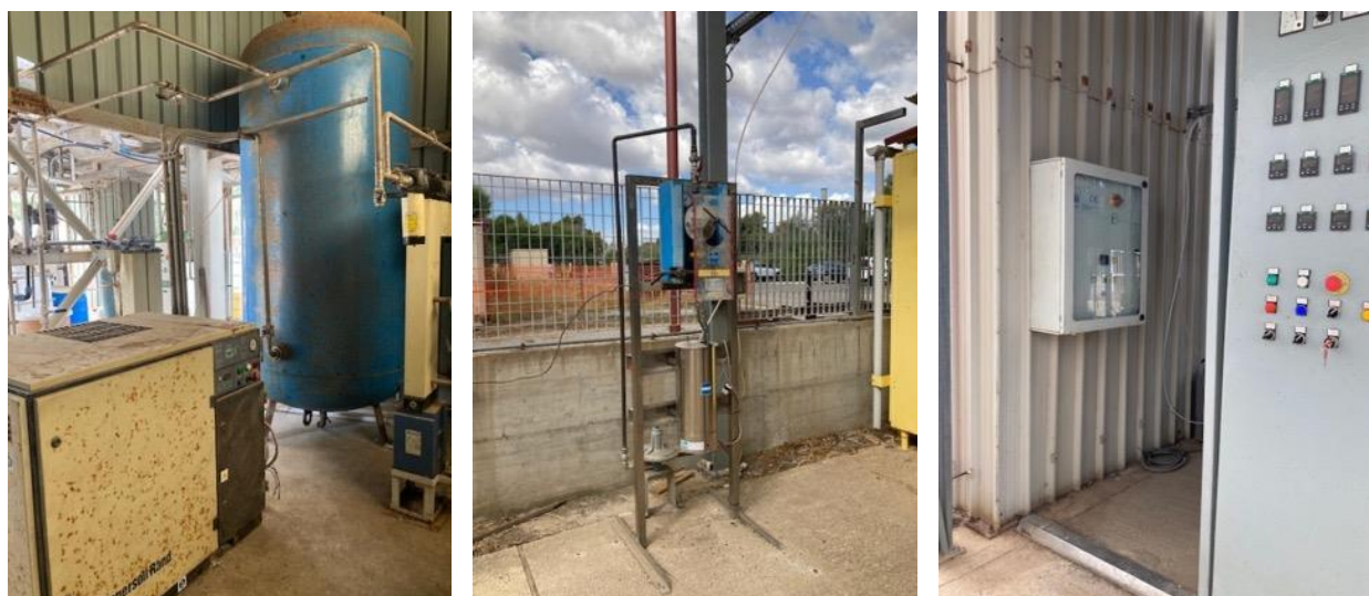
Figura 2.52. Nuova installazione della stazione di compressione aria strumenti, riduttore e riscaldatore CO 2 , preriscaldatore ammine.
