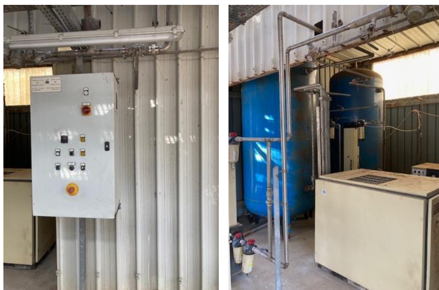
Figura 2.53. Quadro di gestione del riscaldatore agenti gassificanti e nuova disposizione compressori.
